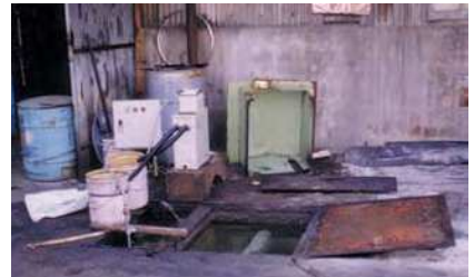
●工場排水ビットへの設置
